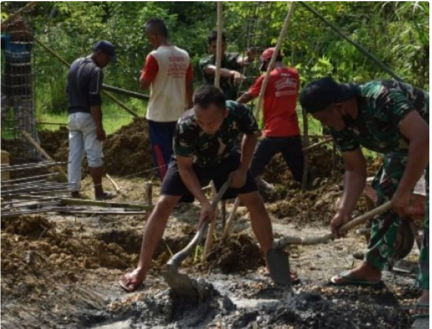
Satgas TMMD ke 113 Kodim 0829/Bangkalan bergotong royong bersama warga membangun Tandon Air
